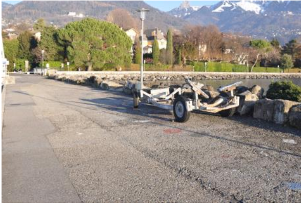
Digue Est - Etat dégradé du bitume
