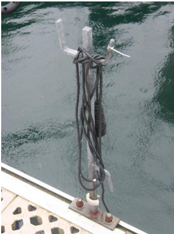
Bricolage pour le raccordement électrique d'une place d'amarrage, risque d'électrocution
