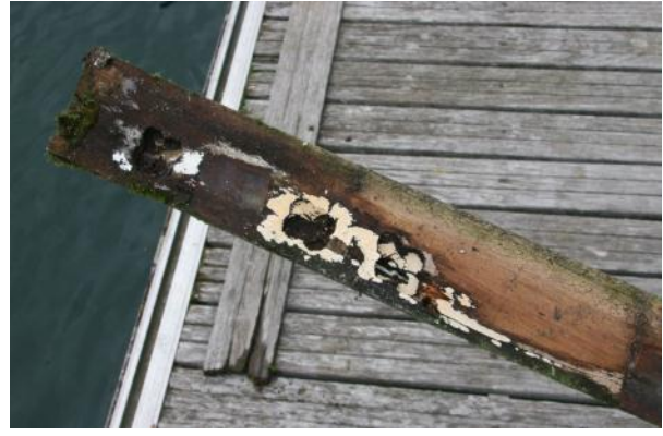
Etat de certaines planches de passerelle
