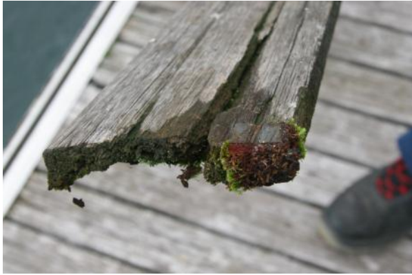
Etat de certaines planches de passerelle
