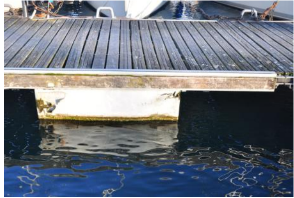
Passerelle n°5 - Vétusté d'un caisson flottant
